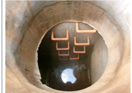
<송수관로 Sta.17+1.5(점검구) 침수(H=1.5m)>
