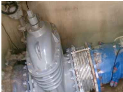
<송수관로 Sta.4+0.0(유량계실) 유입신축관 볼트 부식>
