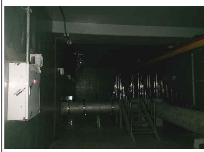
<기계실비(밸브 및 배관) 전경>
