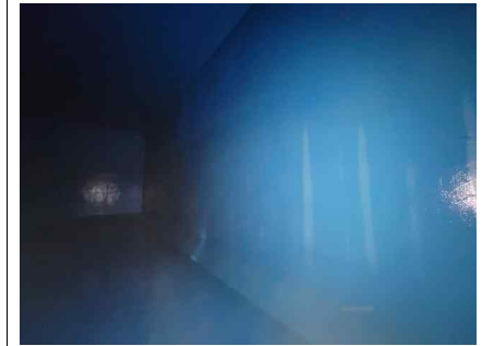
<배수지 2지 벽체 상태양호>
