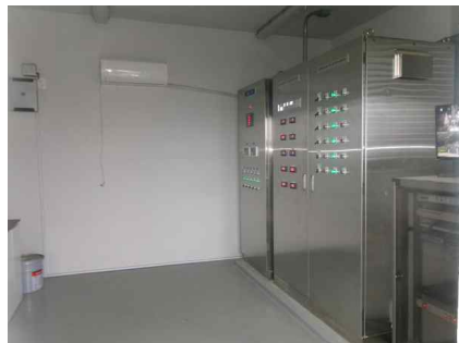
<전기실 내부 전경>
