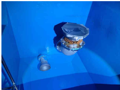
<배수지 2지 유출배관 상태양호>
