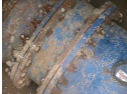
<송수관로 Sta.4+0.0(유량계실) 볼트 부식>
