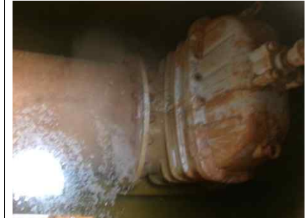
<송수관로 Sta.17+1.5(점검구) 볼트 부식>
