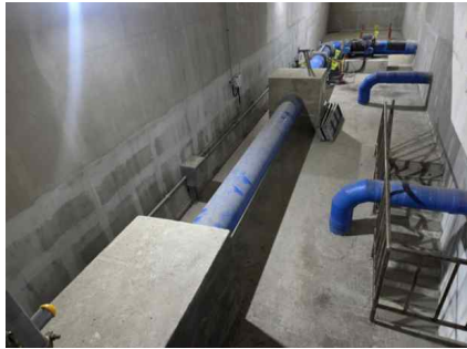
<기계설비(3~4호지 밸브 및 배관) 전경>
