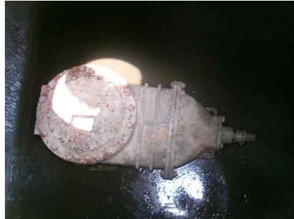
<송수관로 Sta.3+16.1(점검구) 점부식>
